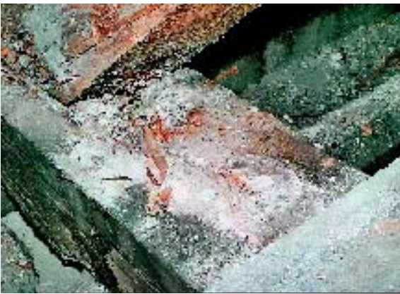
Oberflächliche Ausbreitung des Pilzes zwischen den Bauteilen
