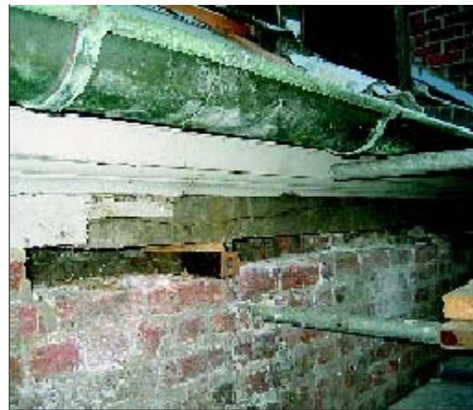
Die profilierte Traufblende aus Eichenholz konnte, nachdem sie in demontiertem Zustand ebenfalls an der Hitzebehandlung teilgenommen hatte, in weiten Teilen wieder montiert werden
